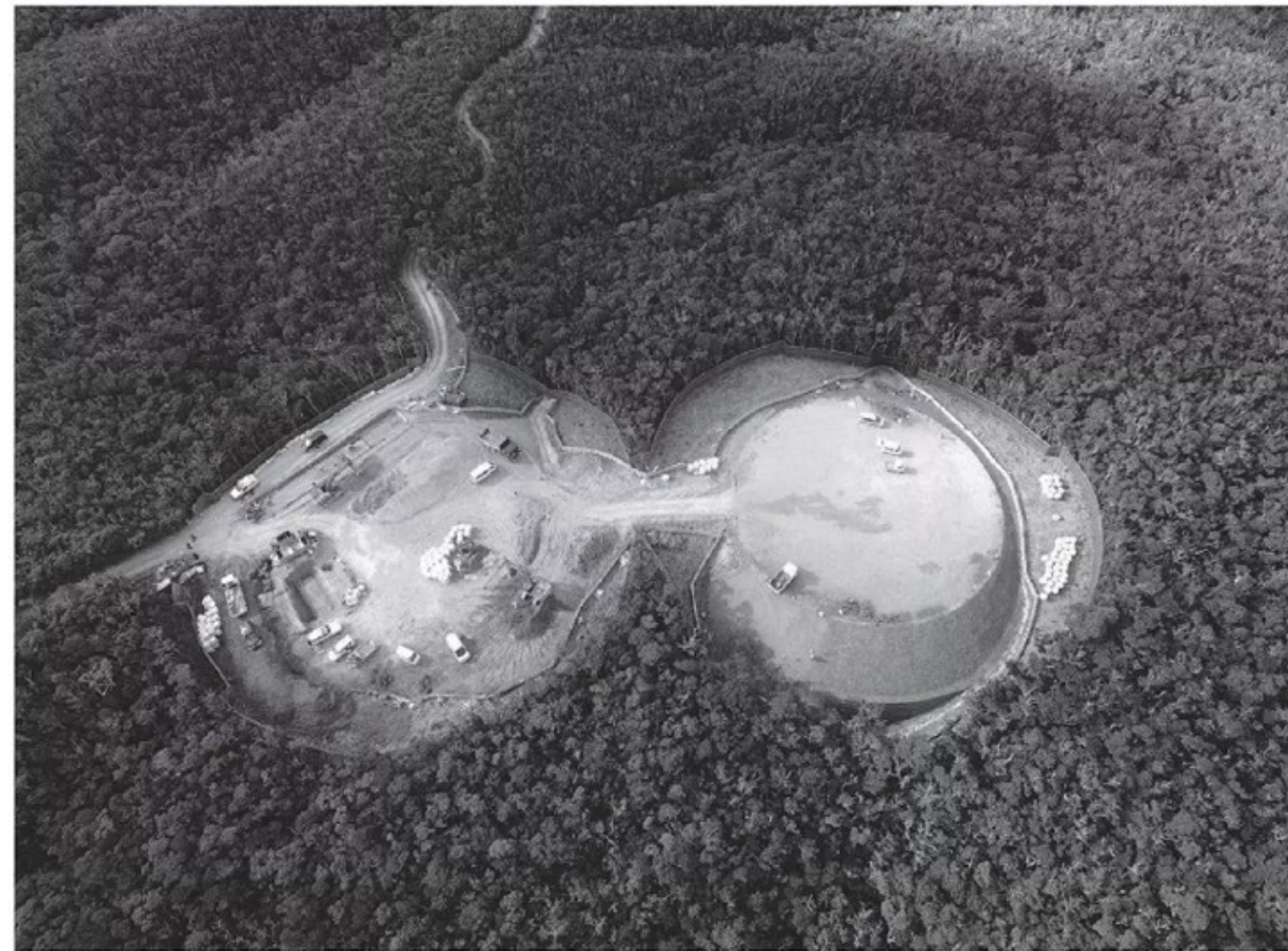
上空から撮影した建設中の高江・ヘリパッド。政府は年内の完成を目指して急ピッチで工事を進めている
